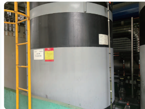
回收水經桶槽收集再利用
