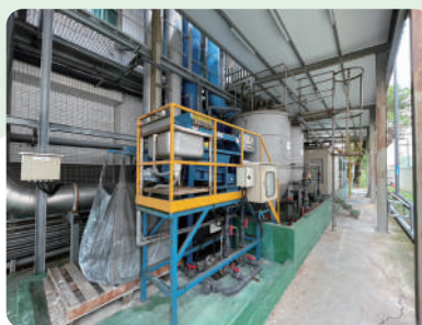
廢水處理系統
